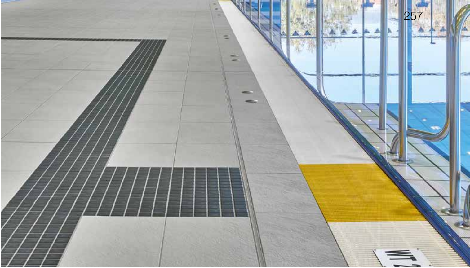
Horner Bad, Bremen, Deutschland / Architekt: janßen bär partnerschaft mbB, Bad Zwischenahn Serien: Emotion, Plural unglasiert / Foto: Jochen Stüber
